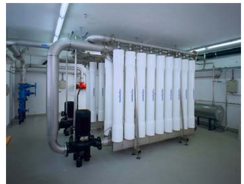
L'installation d'ultrafiltration de Muotathal
